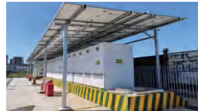
园区用户侧储能项目
